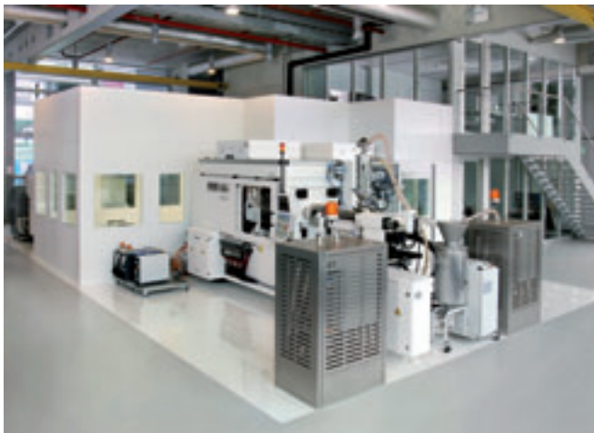
Hohe Anforderungen in der Medizintechnik: Das gesamte Luftvolumen wird im Reinraum 80 mal pro Stunde komplett ausgetauscht.
